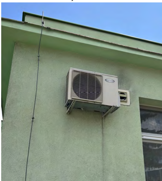
Obrázek č. 2.6.37: Zdroj chlazení
