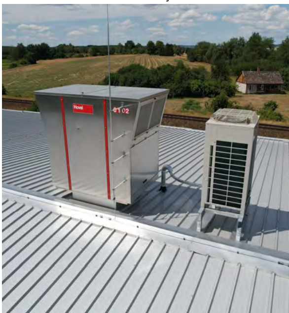
Obrázek č. 2.6.64: Střešní větrací jednotka
